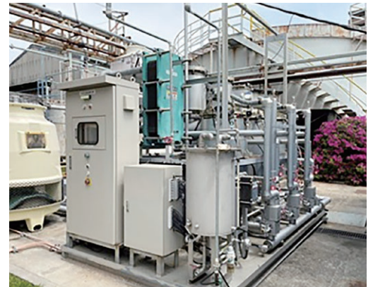
導入プラント 日鉄鋼管株式会社さま (処理量: 150L/hのみ)
