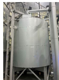
酸発酵槽外観
