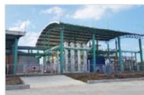
バイオガス精製システム（タイ）
