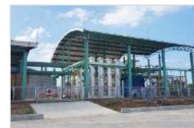
バイオガス精製システム（タイ）
