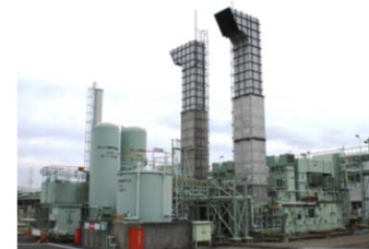
製造所における 自家発電設備の強化
