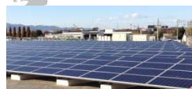
⑯ 西島太陽光発電所 2.9千kW
