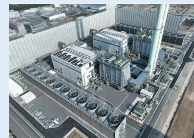
姫路天然ガス発電所
