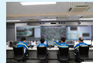
供給コントロールおよび異常監視
