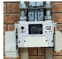
通信ユニット・中継器付き
