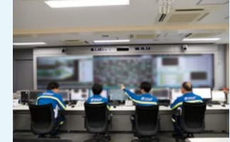
供給コントロールおよび異常監視
