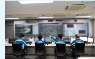
供給コントロールおよび異常監視
