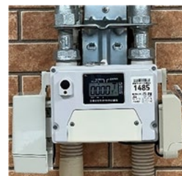
通信ユニット・中継器付き
