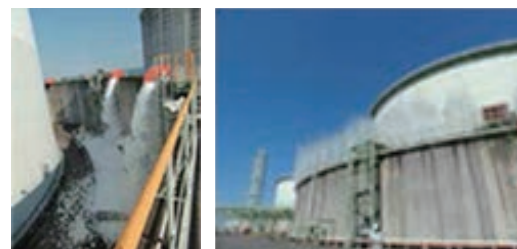
LNGタンクの防液堤に設置している高発泡設備および水幕設備
