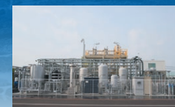
大阪・関西万博でのメタネーション実証設備
