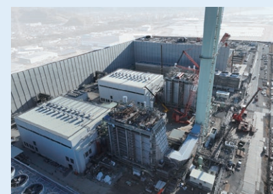
姫路天然ガス発電所
