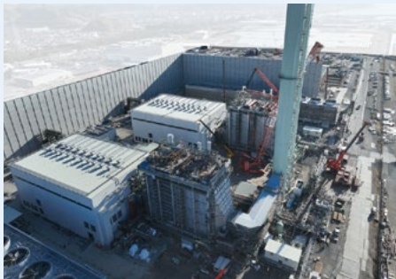
姫路天然ガス発電所
