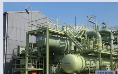
泉北製造所のLNG冷熱発電設備
