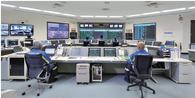
製造所の中央制御室
