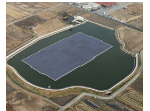
水上太陽光発電設備(兵庫県小野市中島町 前ノ池)
