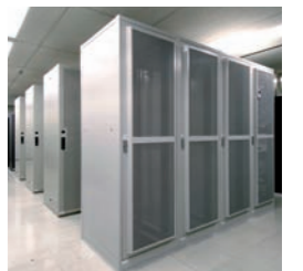
サーバールーム
