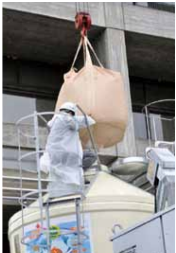
木製ペレット投入の様子
