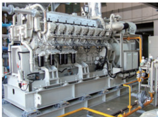
コージェネレーションシステム
