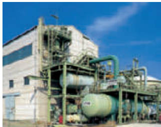
冷熱発電プラント
