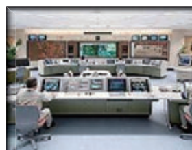
製造所の中央制御室
