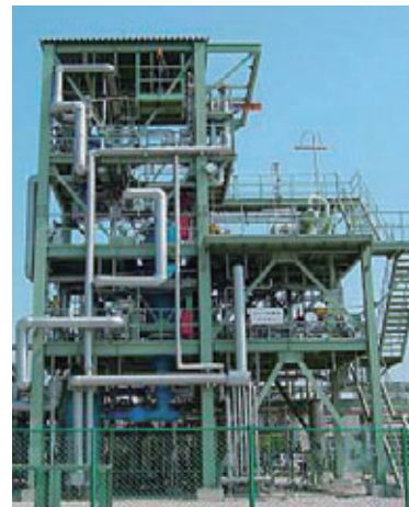
AATGパイロット装置（実証装置）
