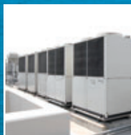
ガス空調システム
