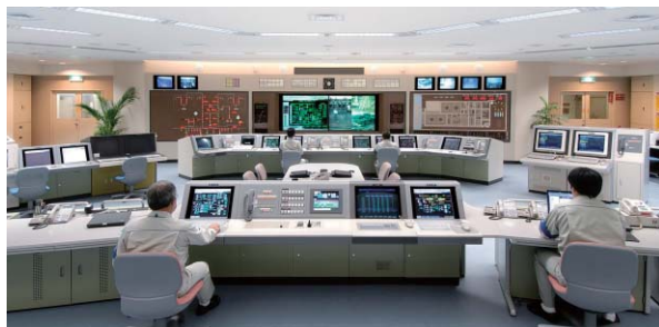
製造所の中央制御室
