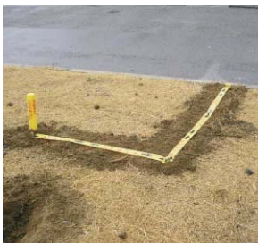
埋設されたガス管の標示
