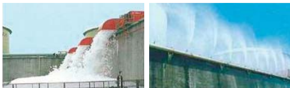
LNGタンクの防液堤に設置されている高発泡設備および水幕設備
