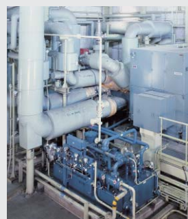
液化ガス製造プラント
