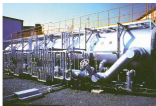
高効率バイオガスプラント
