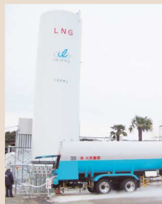
ミナベ化工(株)のLNGサテライト基地
