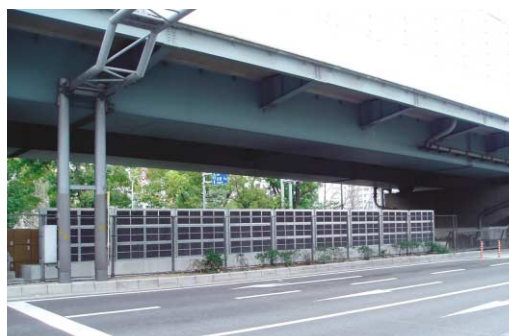
大阪市の国道43号線沿道に試験施工されたACF脱硝ユニット
