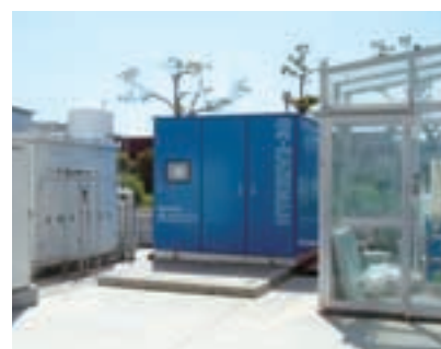
大阪ガス（株）敷地内の水素ステーションに設置された「HYSERVE30※」
