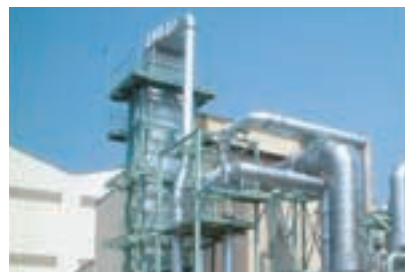
ACF総合排煙処理装置デモプラント 三菱重工業（株）長崎造船所
