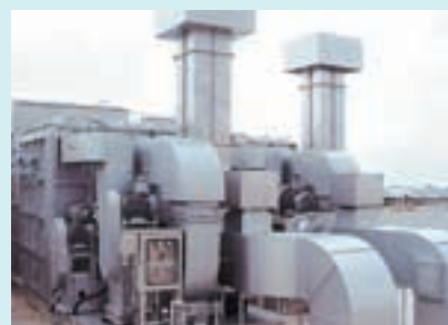
VOC除去装置
