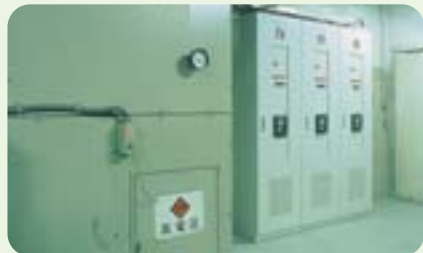
インバーター制御室(パンジョショッピングセンター)
