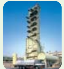
(株)クリオエアの空気分離装置
