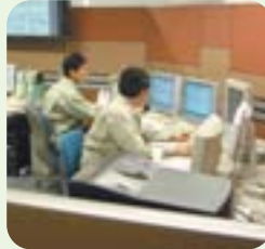
Webコージェネ遠隔監視センター
