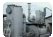
ガス化乾留装置
