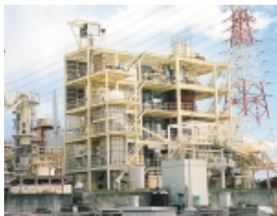
大阪北東エースセンターさまの下水汚泥溶融プラント
