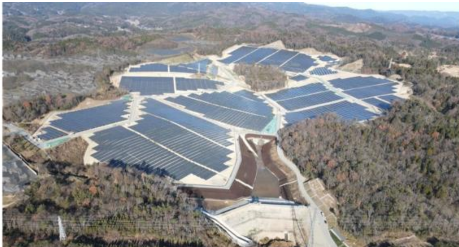
図-7 茨城県北茨城市磯原町特高発電所
