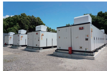
千里蓄電所（大阪府）
