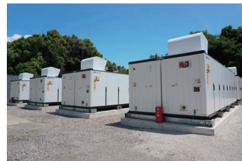
千里蓄電所（大阪府）
