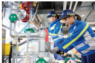
供給設備の安全点検の様子
