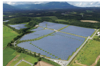
雫石太陽光発電所(岩手県)
