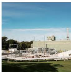
米国ミシガンパワー 天然ガス火力発電所
