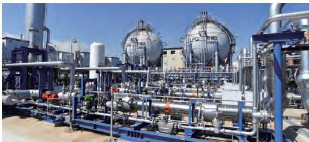
扇島都市ガス供給(株)の熱量調整設備
