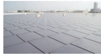
西島太陽光発電所
