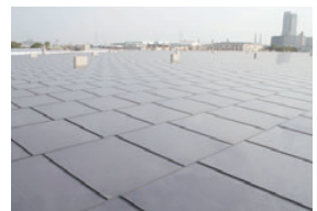
西島太陽光発電所
