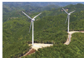
印南風力発電所
