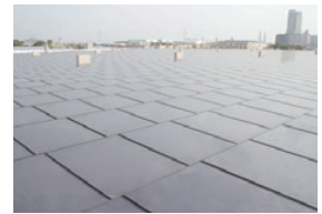
西島太陽光発電所
