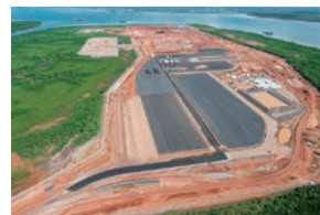
イクシスLNGプロジェクト
