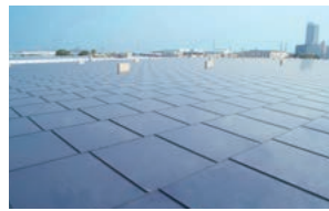
西島太陽光発電所 (大阪府)
