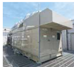
ガスコージェネレーションシステム
