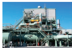
LNG cryogenic power generation facilities at Himeji LNG Terminal
